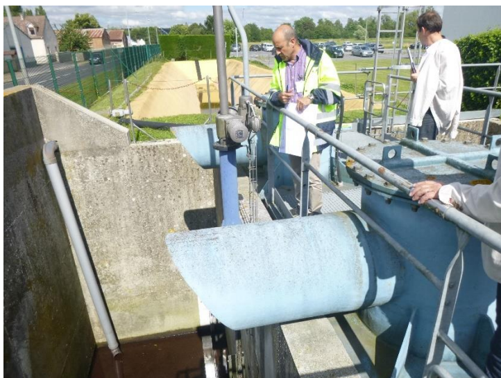
Figure 3-2 : Station de pompage de SANOFI
